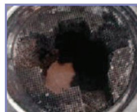
Omfattande invändig skada
